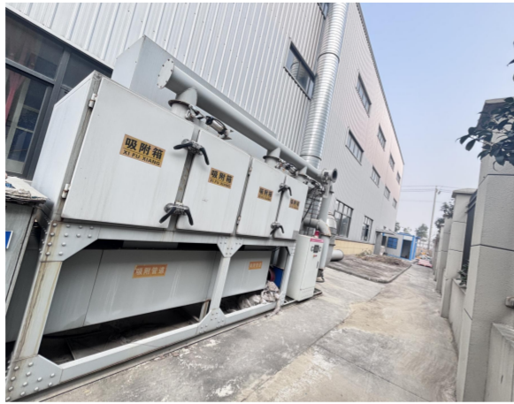
活性炭吸附脱附装置+催化燃烧装置+DA002 排气筒
