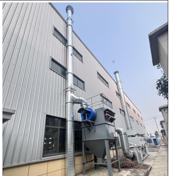
脉冲布袋除尘+DA001 排气筒
