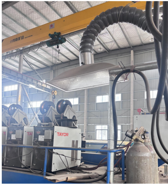
焊接废气收集
